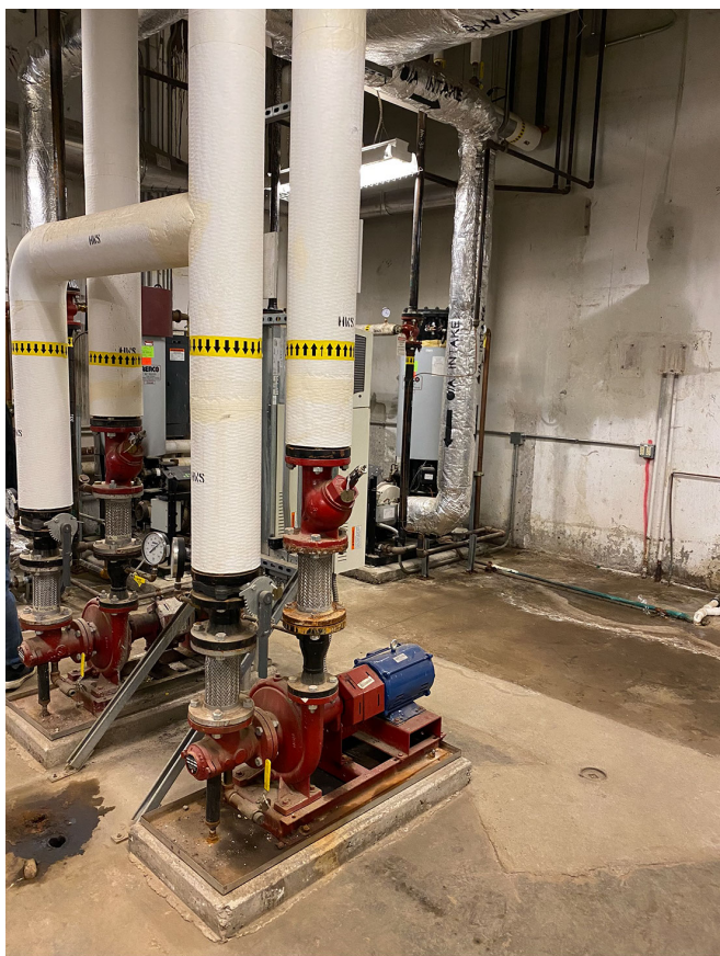
TYP BOILER ROOM (4).JPEG
