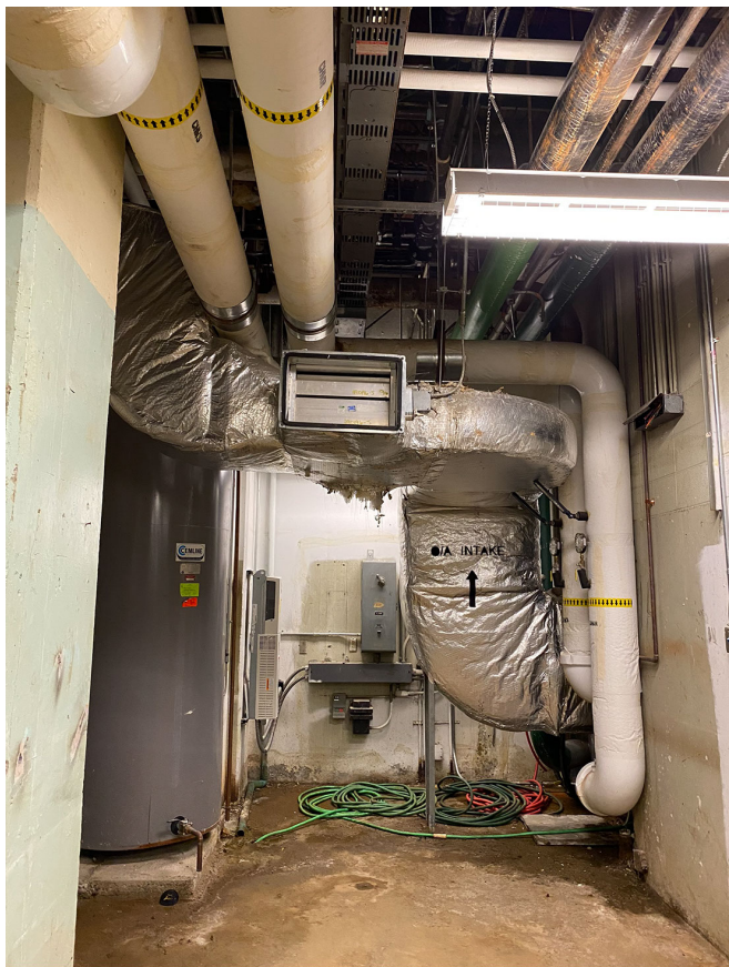
TYP BOILER ROOM (2).JPEG
