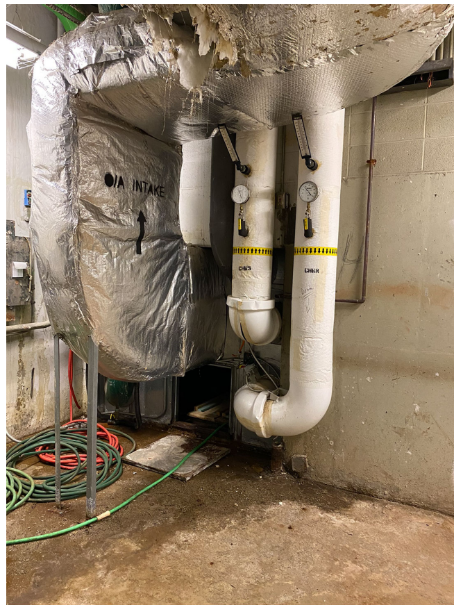
TYP BOILER ROOM (3).JPEG
